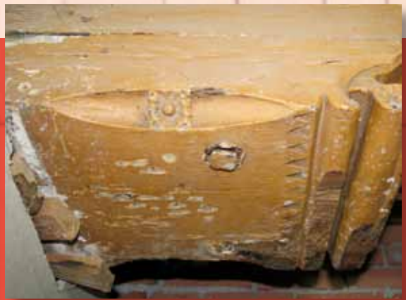
Een beschadigd sleutelstuk (balkdrager) met een peerkraal (dit is de ronde cilindervorm op het uiteinde van de balkdrager).
